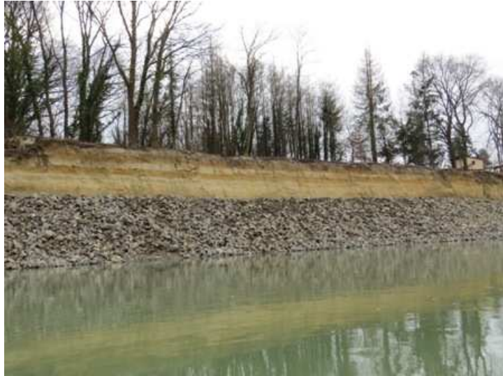
Slika 4. Obaloutvrda Detalj A. Prilikom izgradnje obaloutvrde u cijelosti je uništena kolonija bregunica Riparia riparia ; 22. Siječnja 2014.
